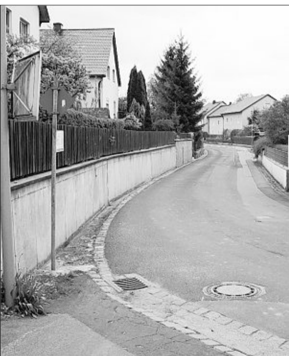
In der Traßlberger Straße werden zwei neue Entwässerungskanäle verlegt und die Straße saniert – beides Schwerpunkte der Dorferneuerung. Bild: ads
